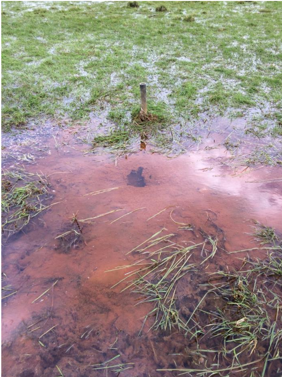
Figur 2-10 Billede fra Gyru8, hvor der strømmer drænvand op gennem brønden til terræn.
