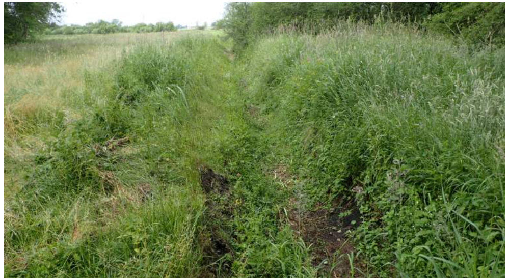
Figur 6-29 Longgrøften i den nordlige ende, var udtørret i sommeren 2018.
